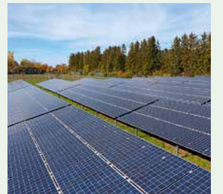
Die Freiflächen-Solaranlage in Riedmoos wird von den Stadtwerken betrieben und erzeugt Strom für ca. 170 Haushalte
