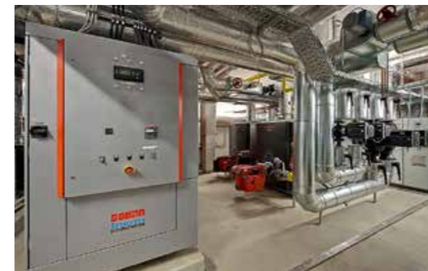
Eigene Energieversorgung im Infinity Hotel: Das Blockheizkraftwerk mit Grundwasser-Wärmepumpe beheizt mehr als 400 Zimmer samt Wellnessbereich
